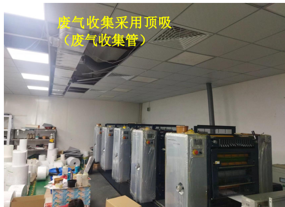
图 3-1 废气治理措施现场照片
