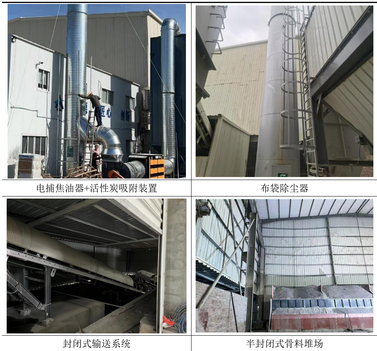
图 4-1 废气治理设施照片
