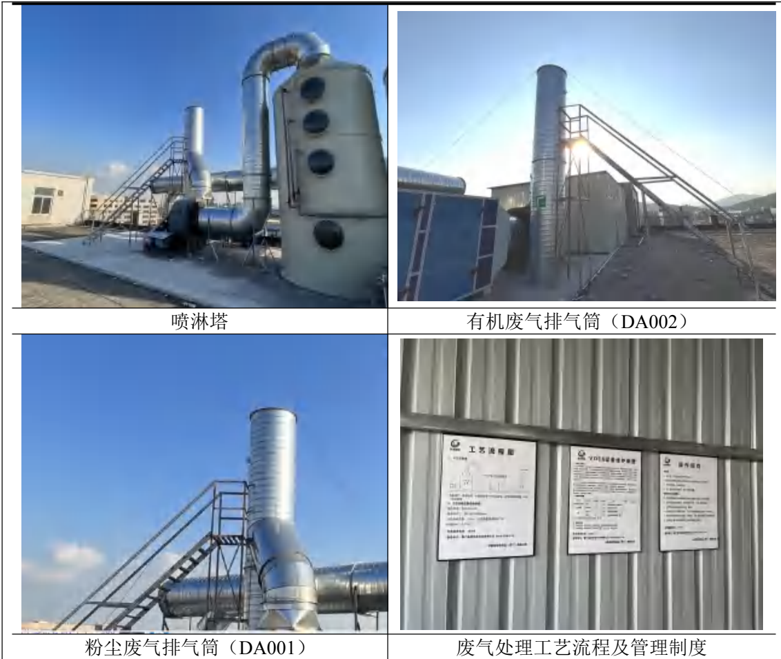
图3.2-3 相关废气处理设施照片
