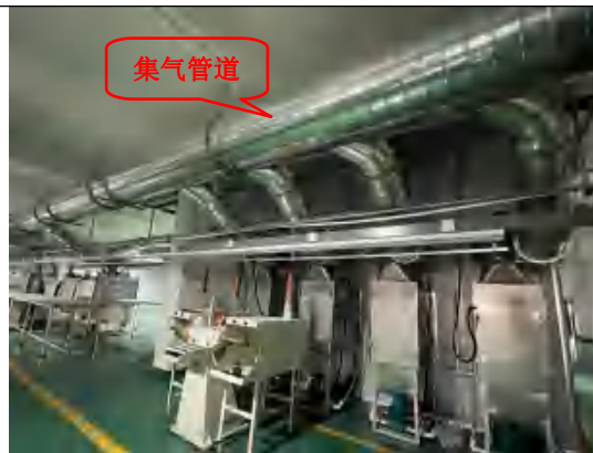
喷漆水帘柜集气管道
