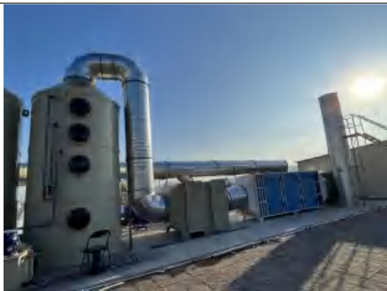
“喷淋塔+干式过滤器+活性炭吸附”处理设施
