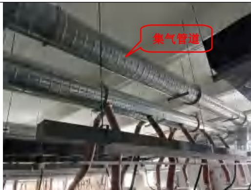
抛光车间废气收集管道
