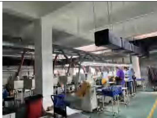
抛光车间废气收集管道
