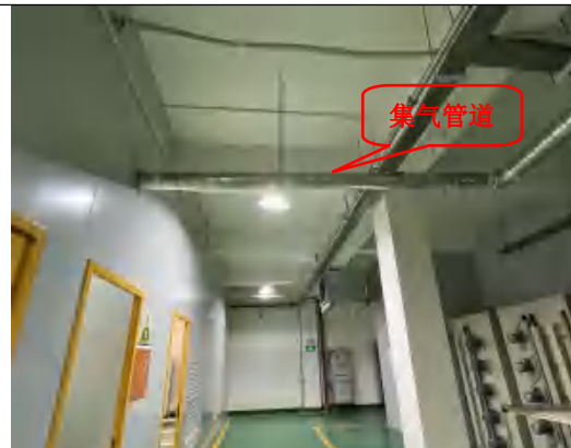
危废间集气管道
