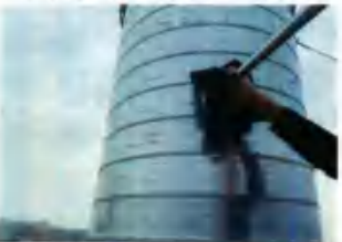
喷漆有机废气处理设施◎P2 出口
