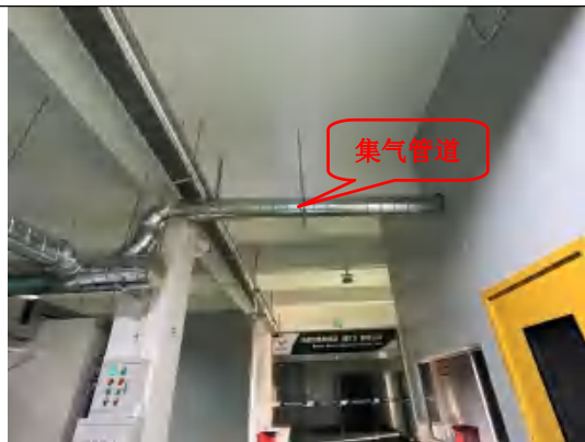
调漆房集气管道
