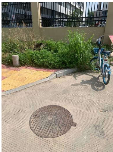
市政雨水排放口
