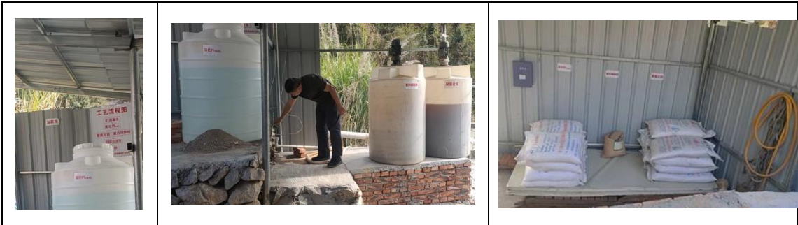
加药间（加药流程牌、储存及台账）
