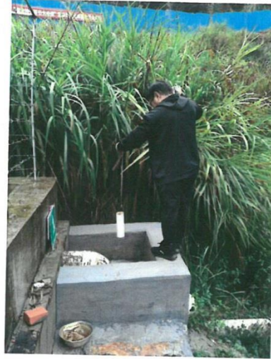
污水排放口 W2
