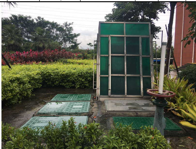
图 3-1 园区污水处理站现场照片
