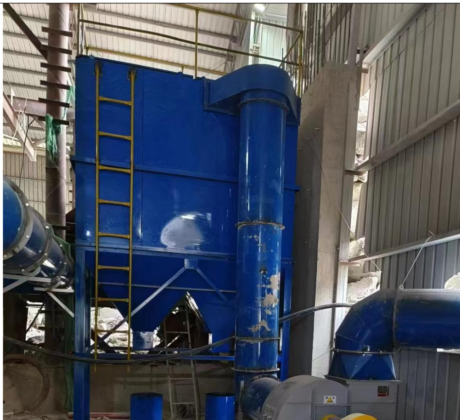
布袋除尘设施
