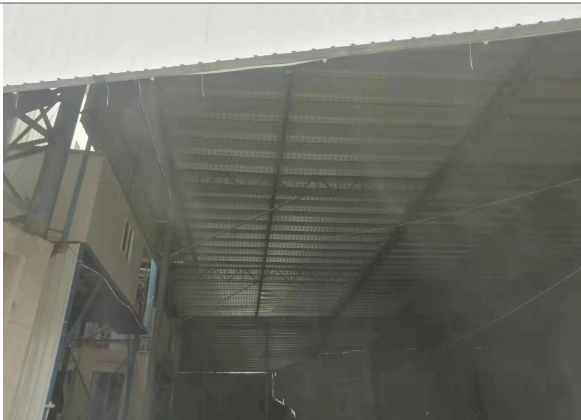
车间雾化喷淋装置
