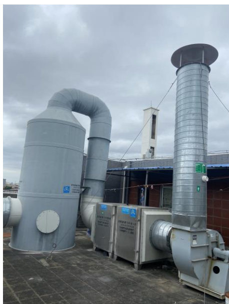
有机废气处理设施
