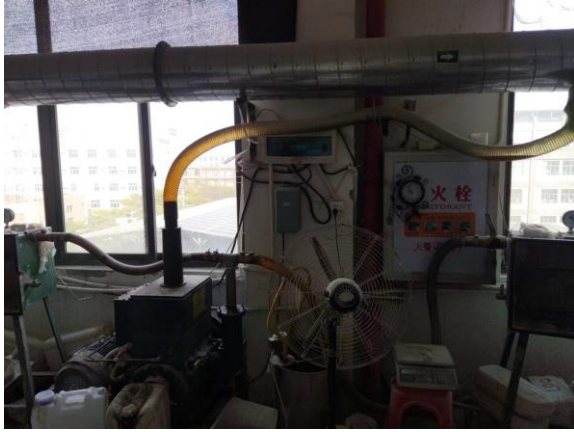
成型车间废气收集管道
