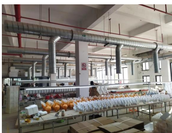
彩绘车间废气收集措施-集气管道
