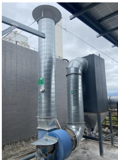
粉尘废气处理设施
