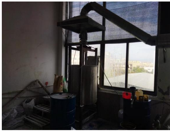
投料废气收集措施
