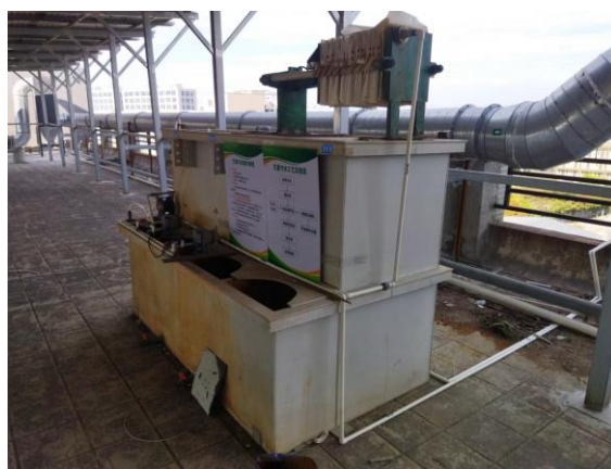
图 4-1 废水污染防治措施照片
