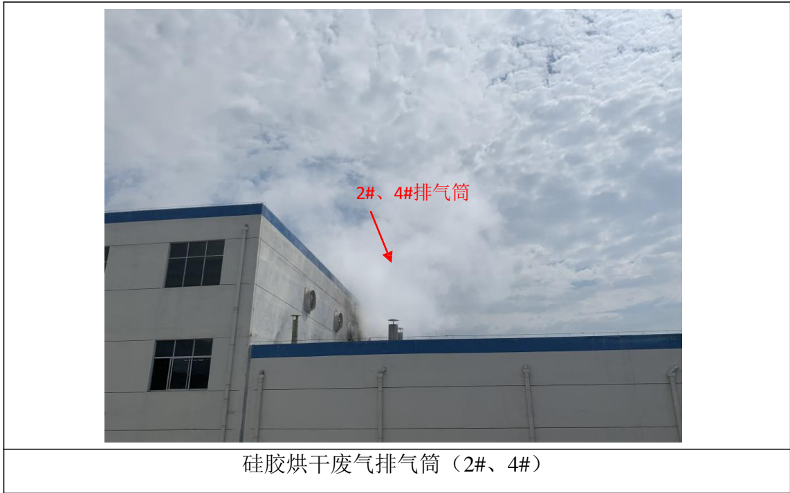
图 3.3-5 硅胶烘干废气治理设施现场情况
