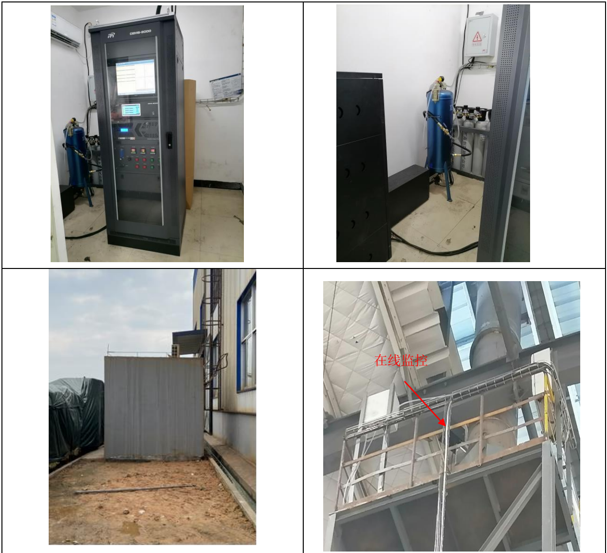
图 4.1-12 生物质炭废气在线监测设施现场情况
