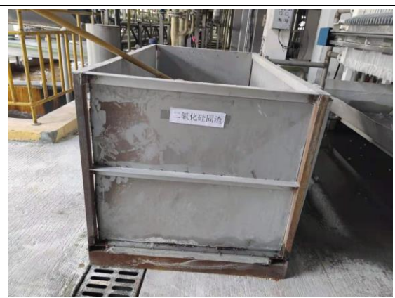
车间硅胶渣存放柜
