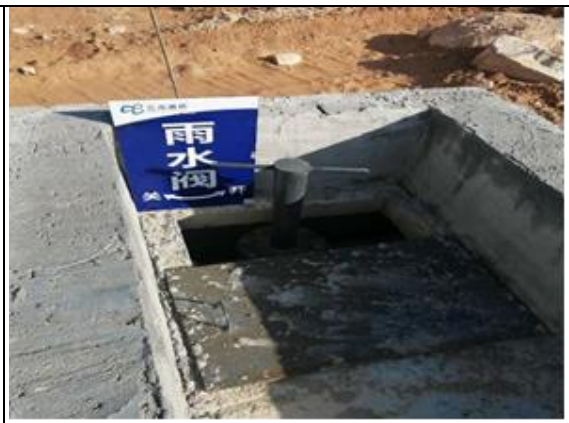
雨水总排口闸阀
