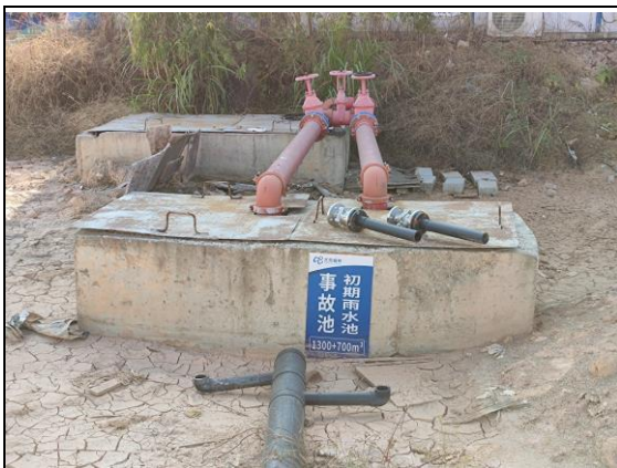
事故池及初期雨水池
