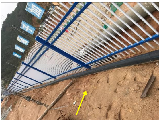
排污管 (外接元力污水管)
