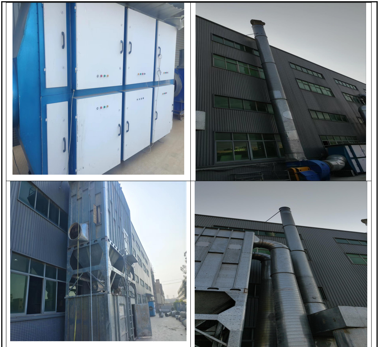
图 3-1 废气处理设施图
