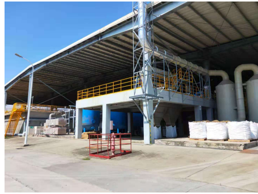
园区污水处理站
