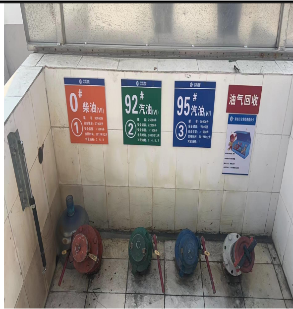
加油站一次油气回收装置
