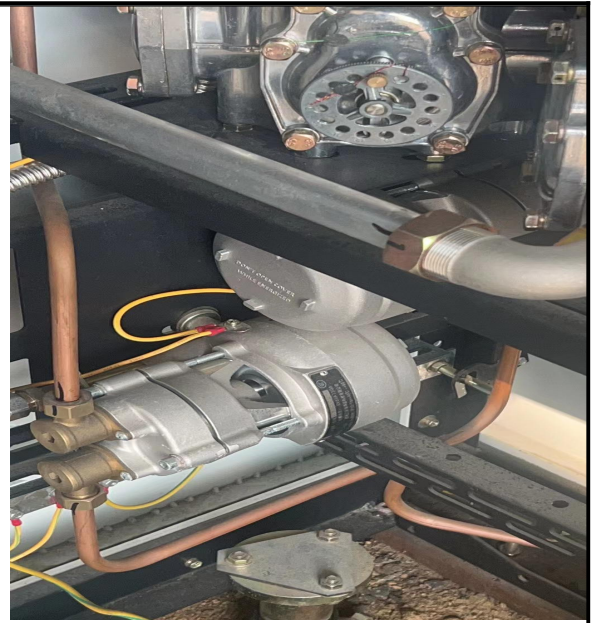
加油站二次油气回收装置
