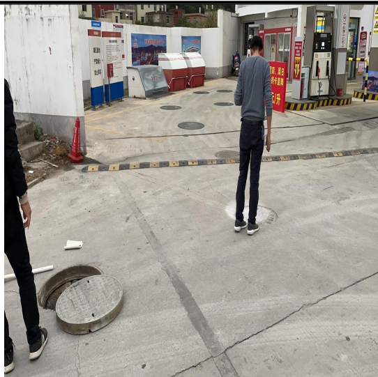
路边污水管口
