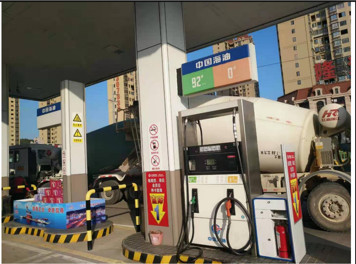
加油岛内警示标志、消防器材
