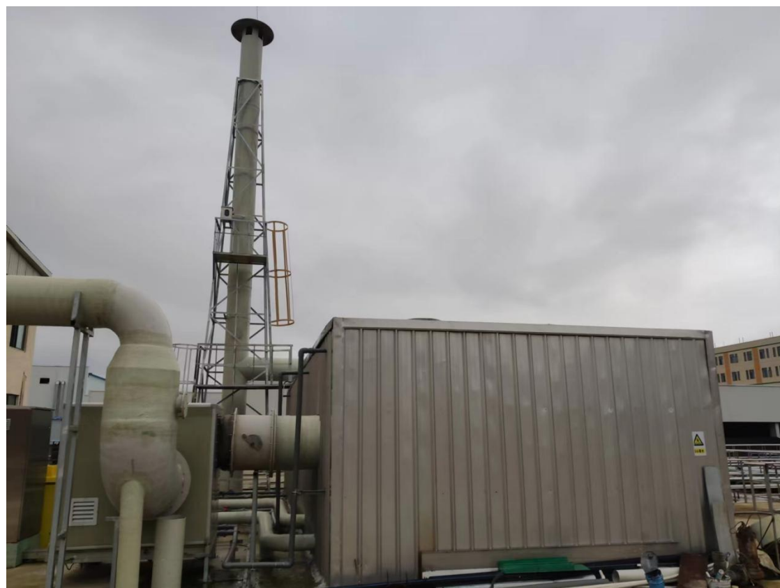
废气处理设施
