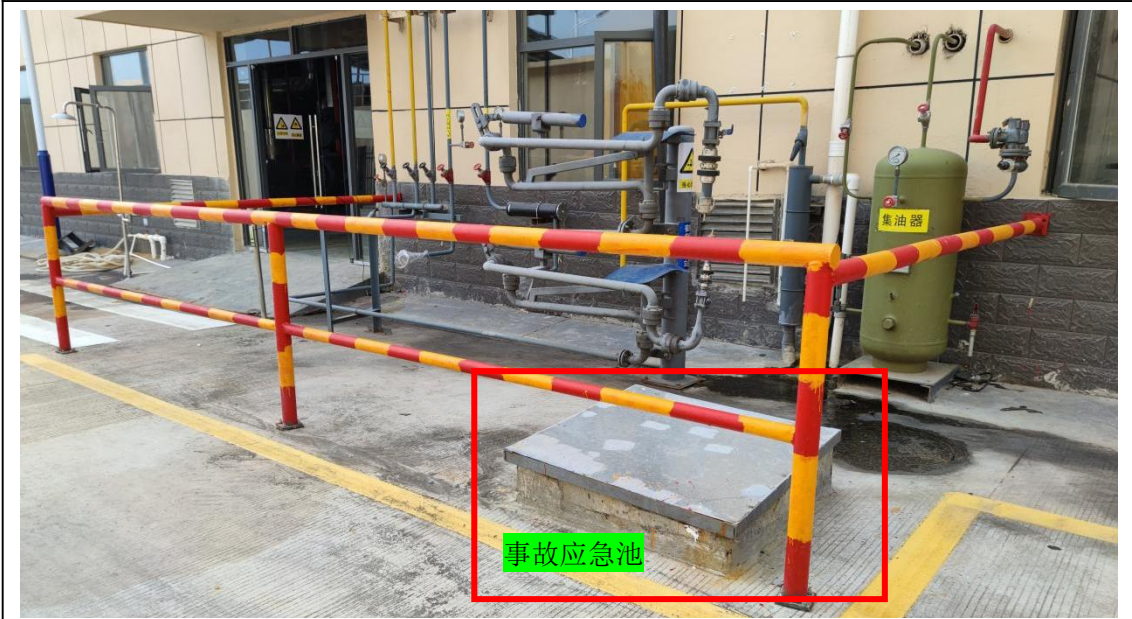
集油器、事故应急池
