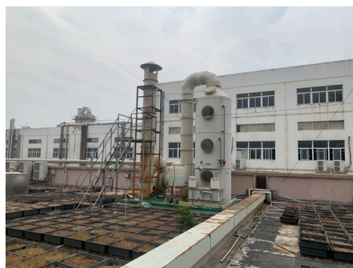
FQ-409501 排气筒、“碱液洗涤”处理设施
