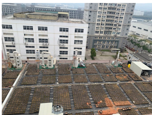
2#楼排气筒、废气处理设施
