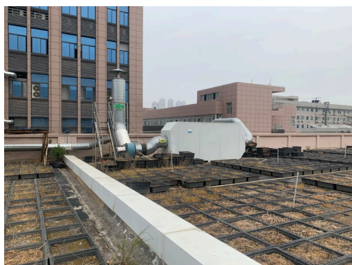
FQ-202218-2 排气筒、活性炭处理设施
