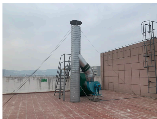
FQ-202218-3 排气筒、活性炭处理设施
