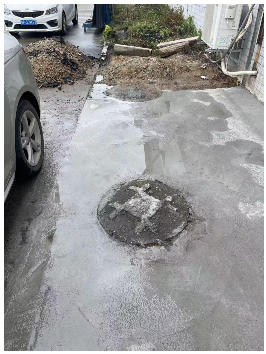
化粪池、地埋式生活污水处理设备
