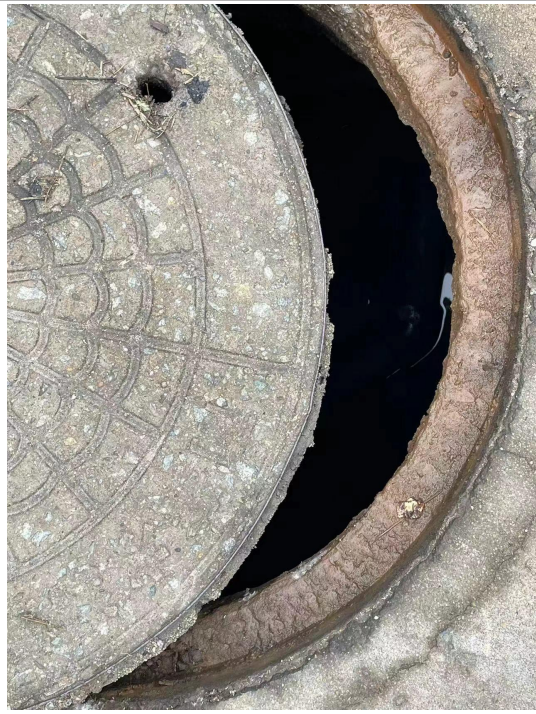
化粪池、地埋式生活污水处理设备
