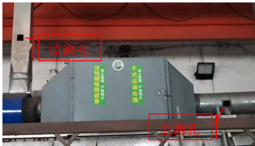
活性炭吸附装置 Y1 排气筒
