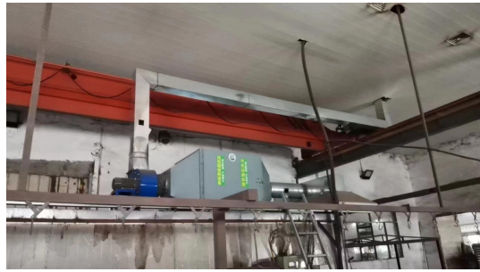
活性炭吸附装置 Y1 排气筒
