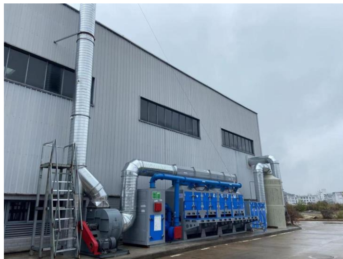
喷淋塔+干式过滤+活性炭吸附脱附+催化燃烧+15m 排气筒
