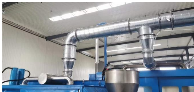
密闭设备+集气管道
