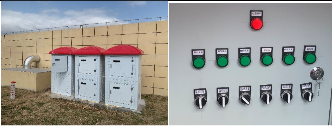
图4-8 项目污水处理设施现场照片
