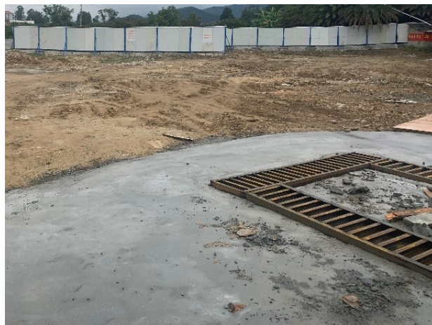
图4-4 施工期洗车台
