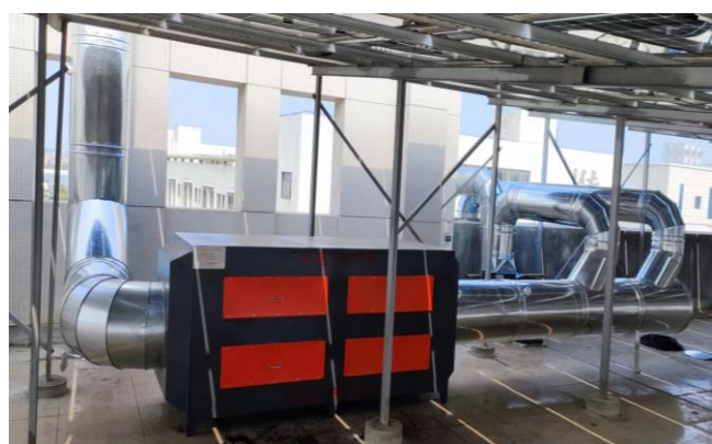
“袋式除尘+活性炭吸附”处理设施 (P1)
