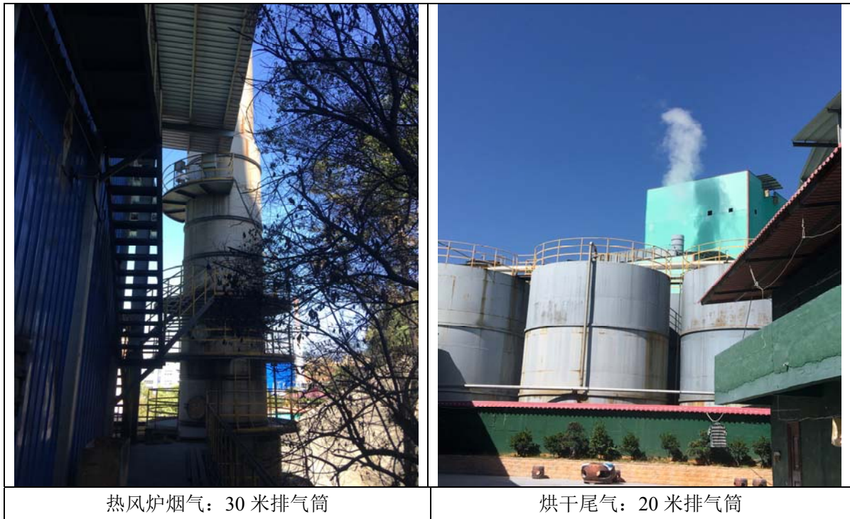
图 4.1-3 废气处理设施现状图
