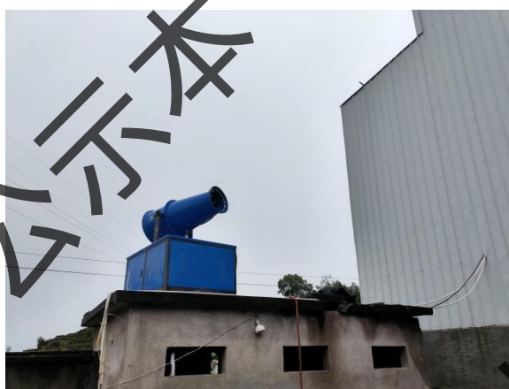
喷淋降尘设施
