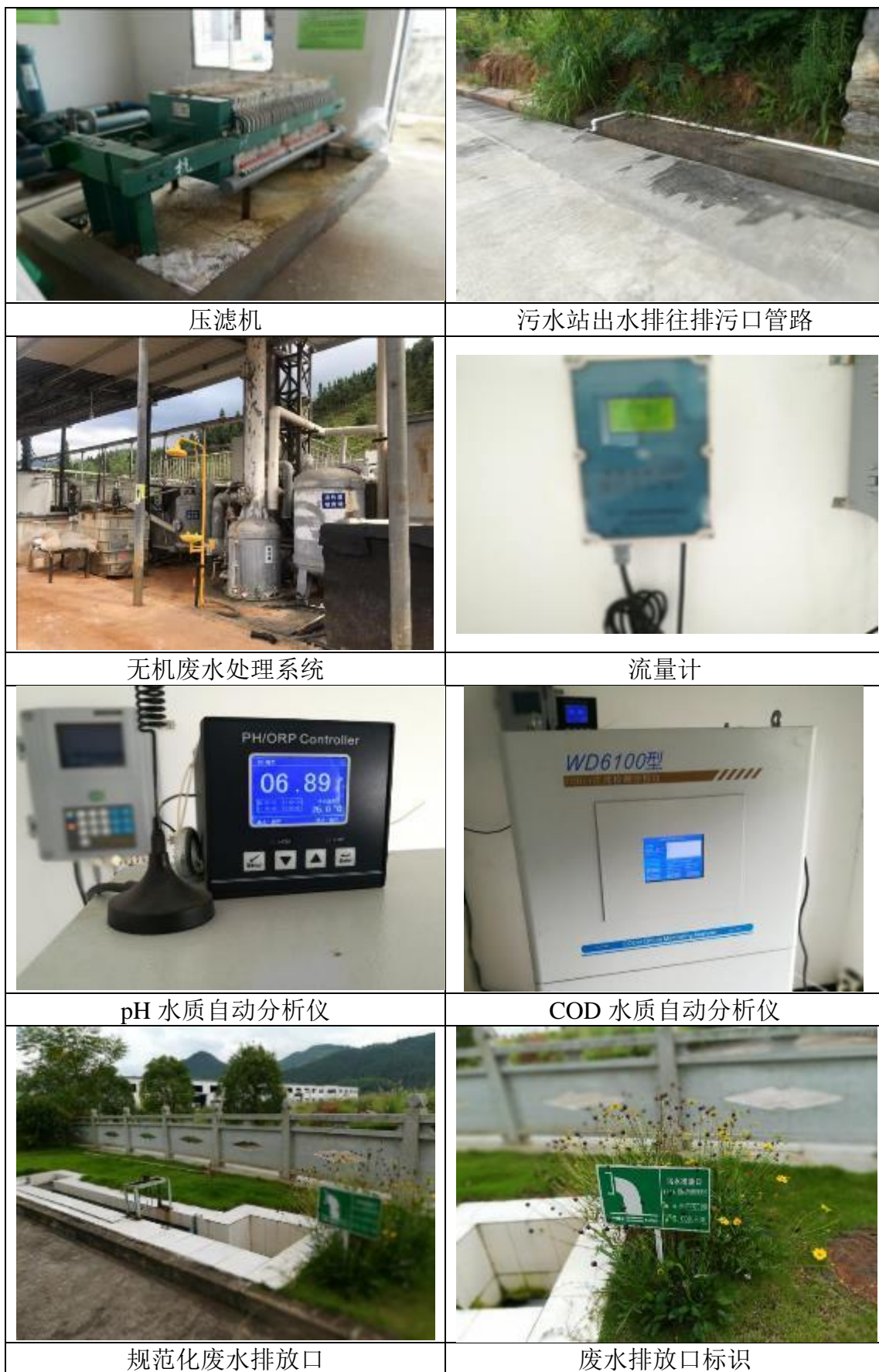
图 3.3-4 现有工程污水处理设施现场状况图
