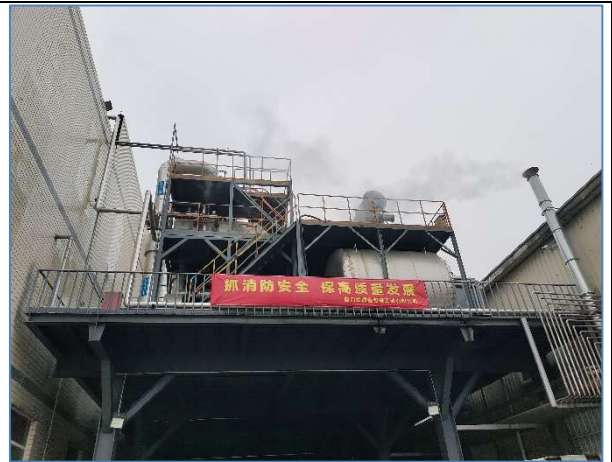
废气处理设施
