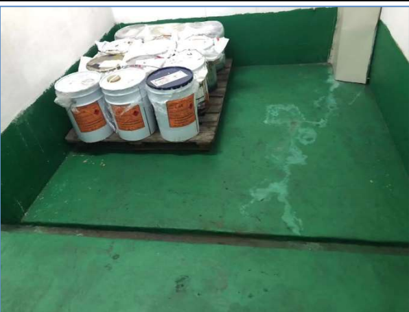
危险废物导流沟
