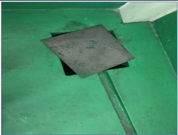
危险废物集污槽
