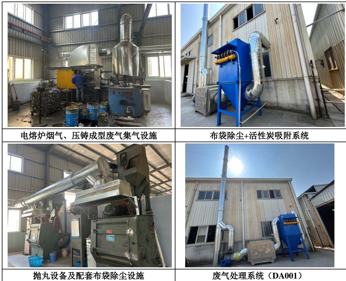
图 4.1-2 废气处理设施照片
