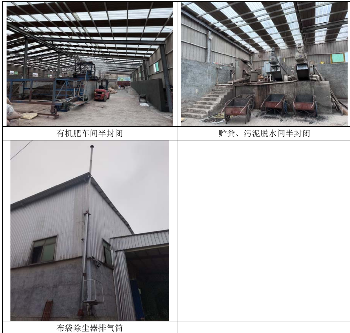
图 4.1-3 废气处理设施现状图
