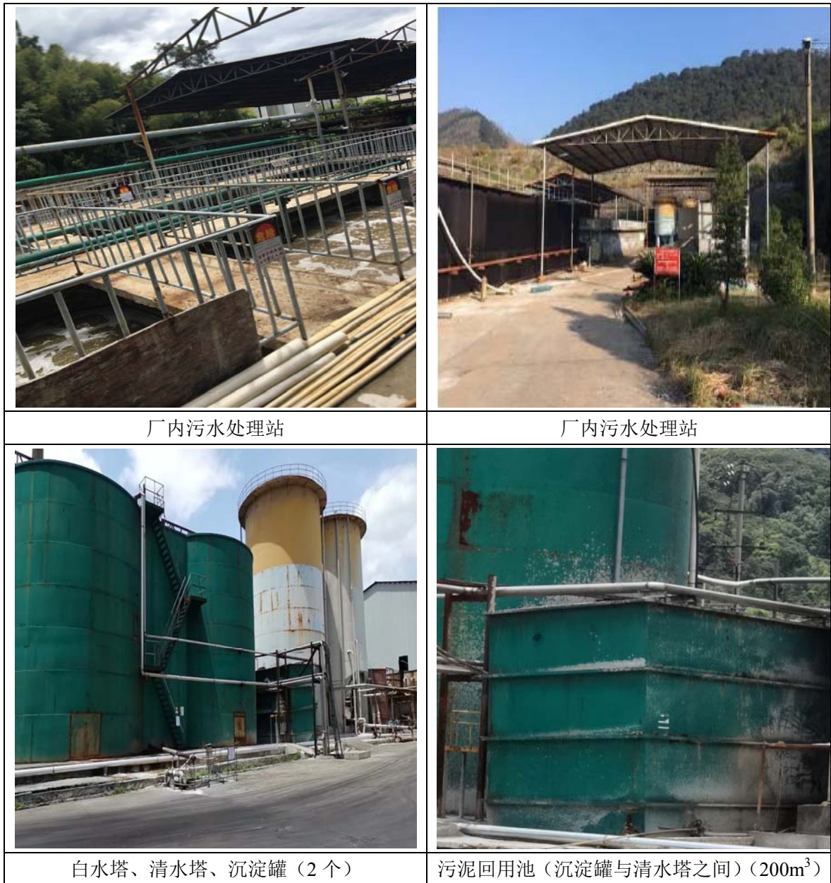
图 4.1-2 项目废水治理设施图
