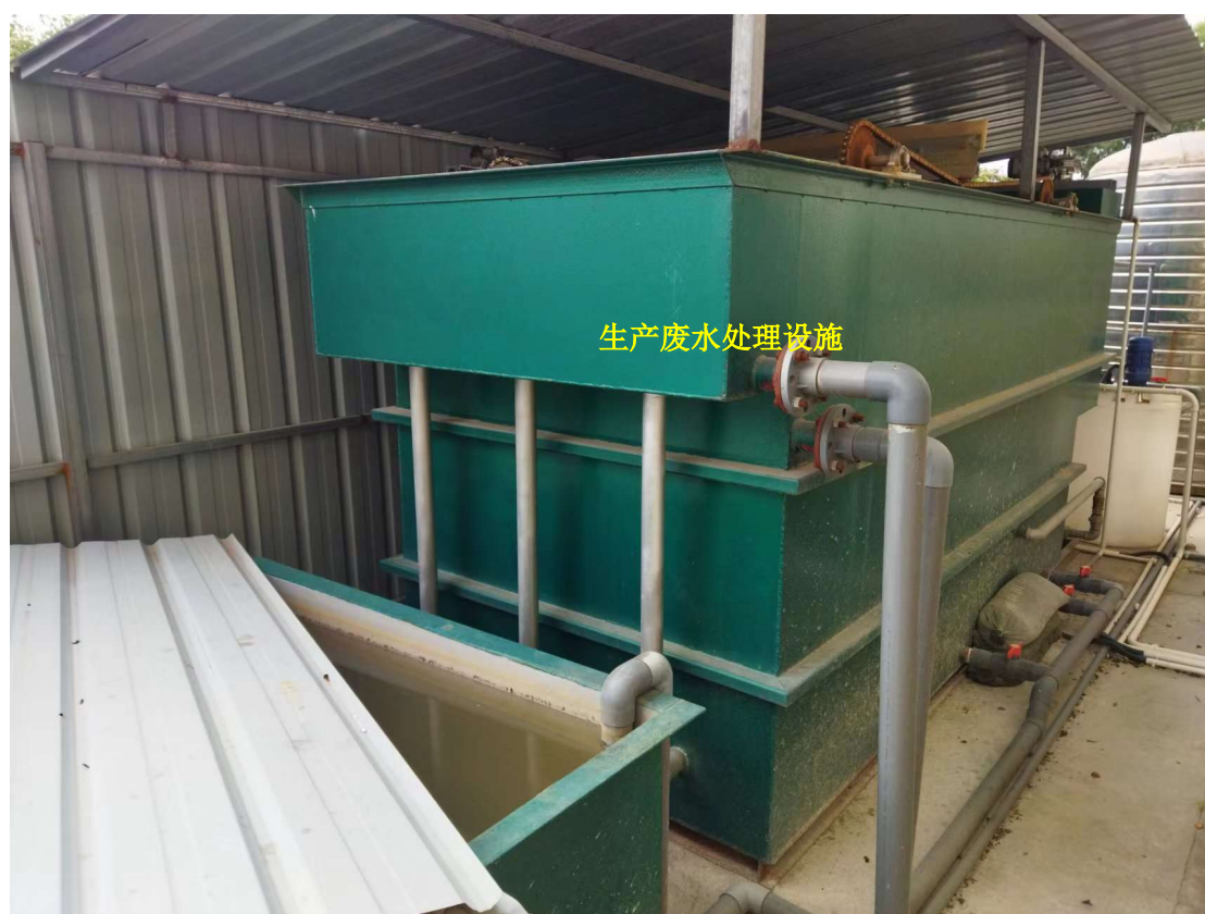
图 3-1 生产废水治理措施现场照片
