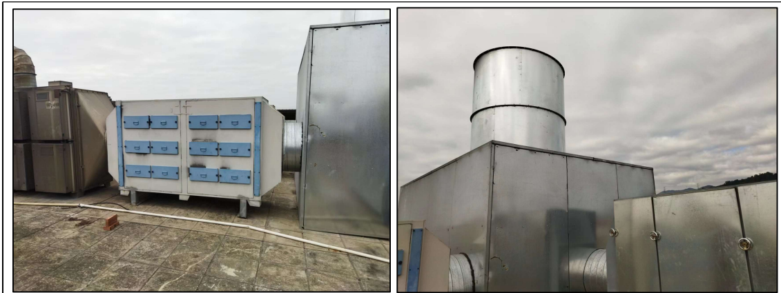
活性炭吸附装置、排气筒
