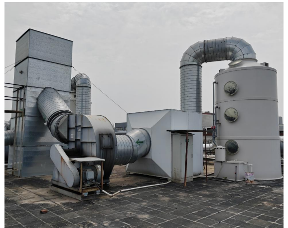
楼顶废气处理设施
