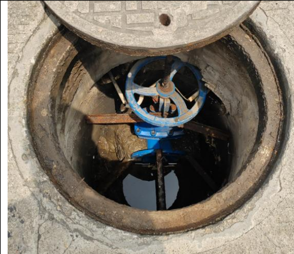
雨水排放口围堵设施（阀门）
