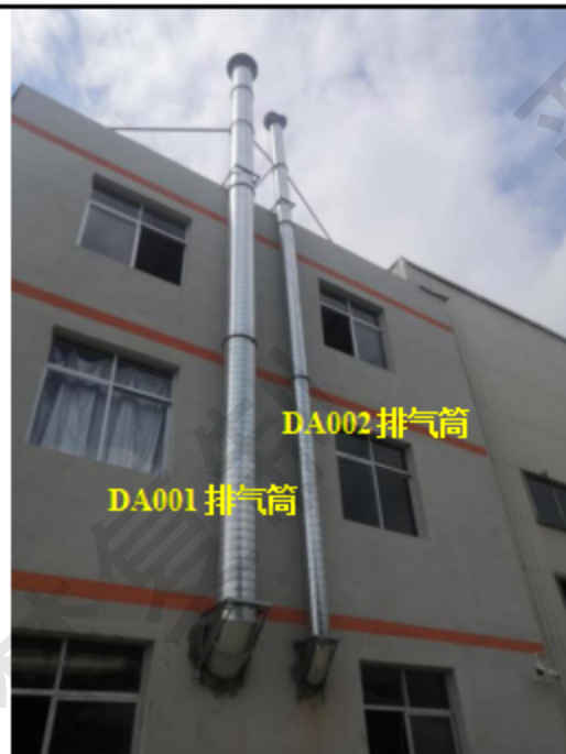
生产废气排气筒
