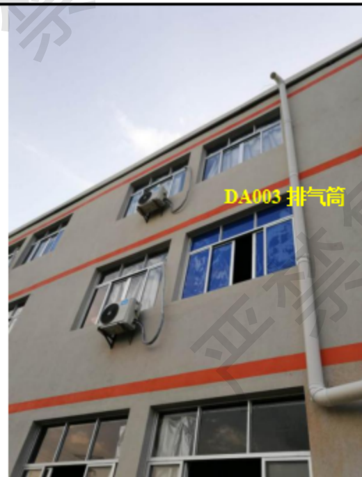
油烟废气排气筒
