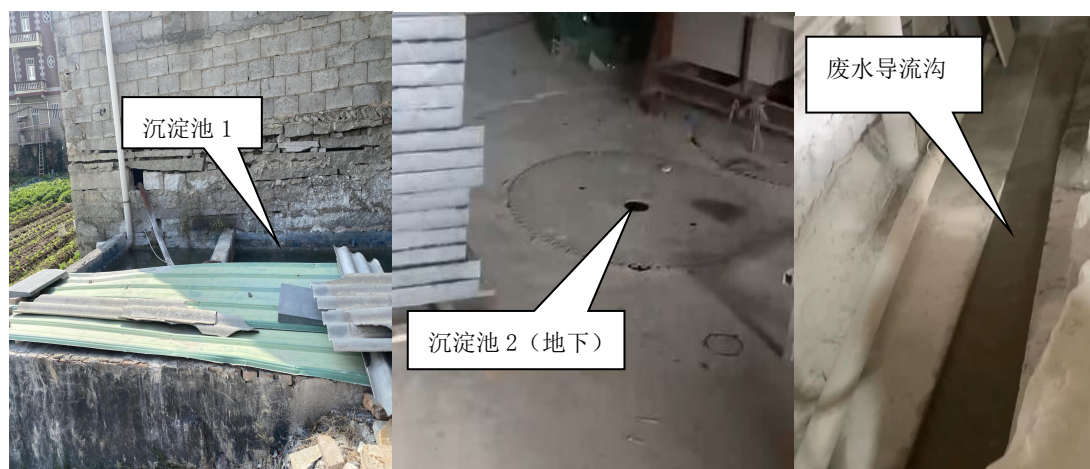
图 4-2 废水处理设施
