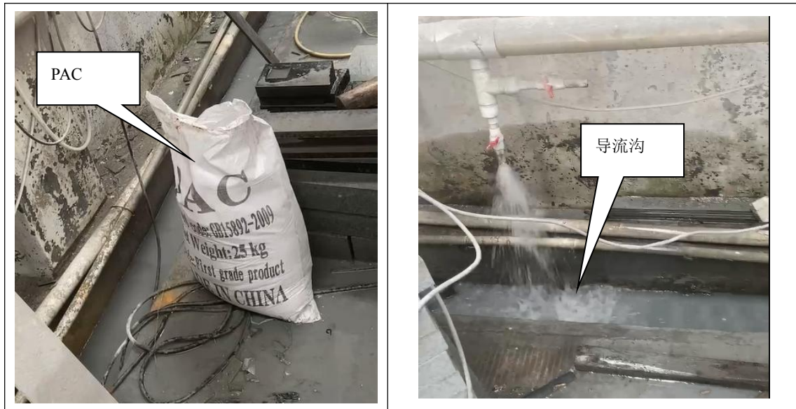
图 4-2 废水处理设施
