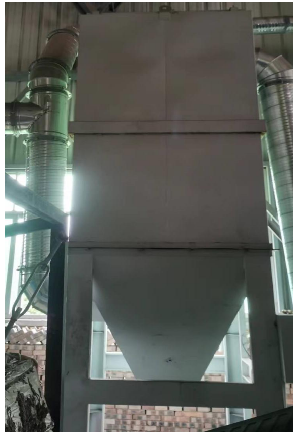
2 # 袋式除尘设施
