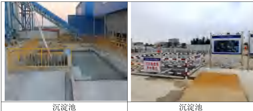
图 7-3 施工期废水处理设施
