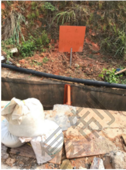
雨水切换阀门标识牌
