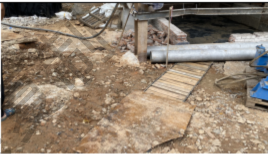
1号生产区域应急管道
