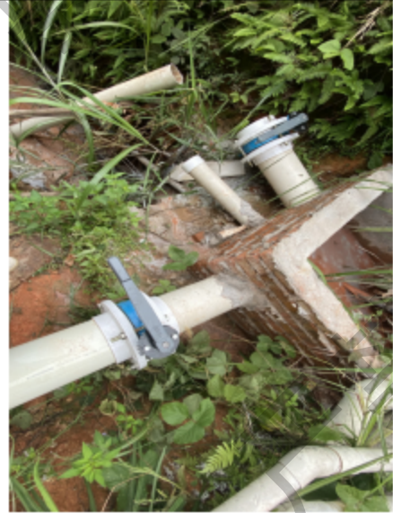
2号生产区域应急管道
