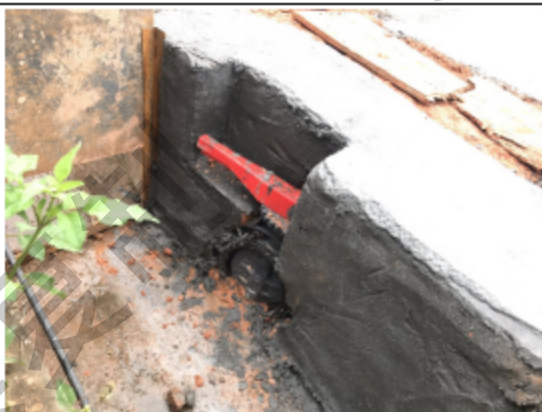
雨水沟切换阀门
