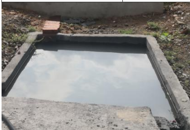
轮胎冲洗废水沉淀池
