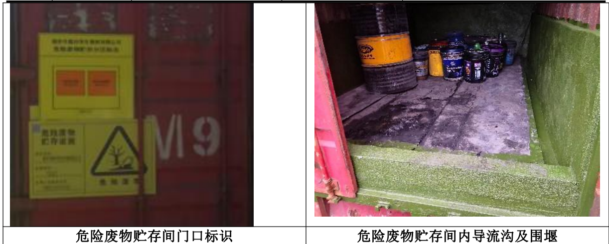
图 4.1-3 危险废物贮存间照片
