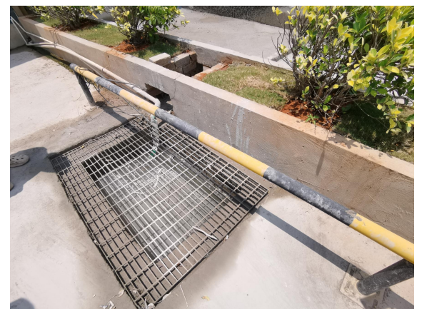
截水沟和收集池
