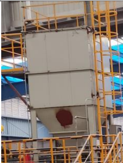
磷石膏制粉煤仓除尘器
