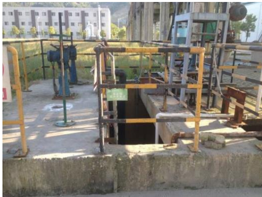
初期雨水、事故废水一级切换阀
