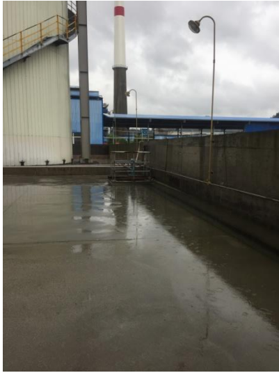
磷酸罐区事故水收集系统
