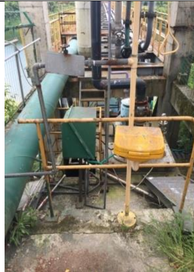
初期雨水、事故废水末端切换阀、提升泵
