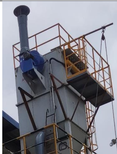
磷石膏制粉煤输送中转除尘器
