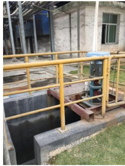
磷酸二铵装置区收集池
