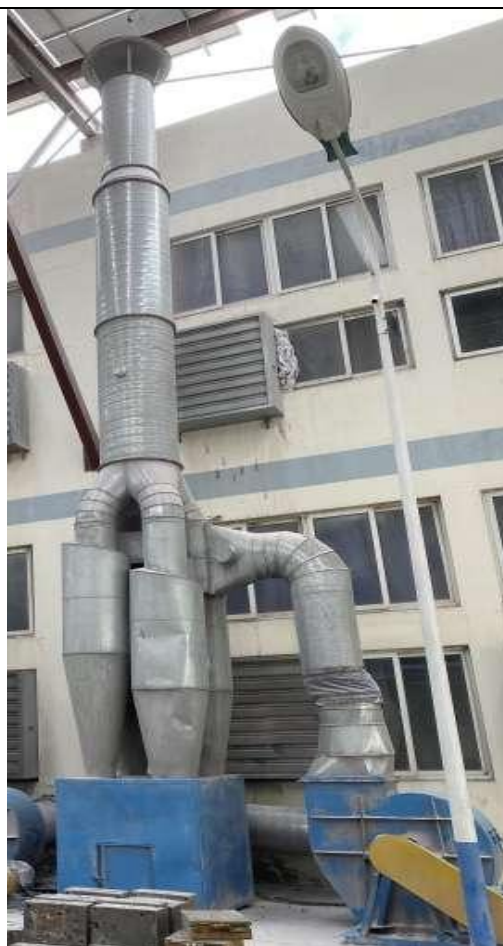
MD 中底打粗废气处理设施
