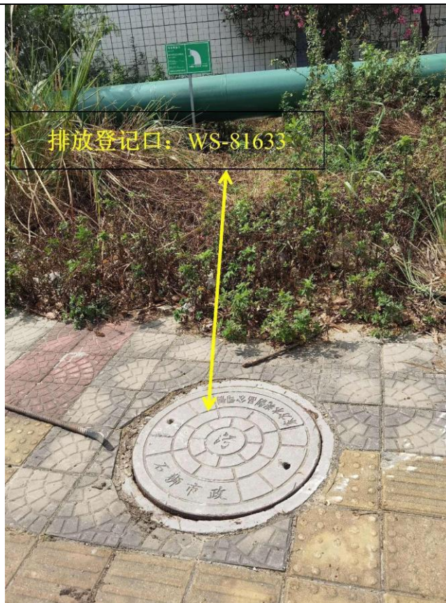
生活污水排放口
