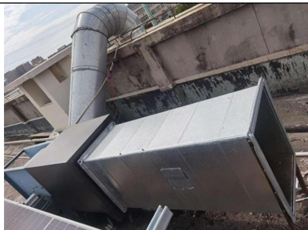
食堂油烟处理设施
