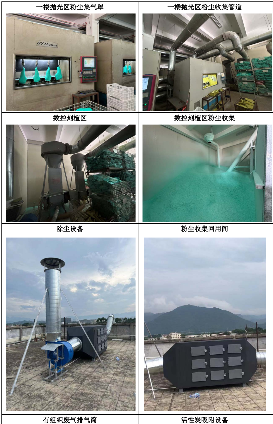
图 4.1-2 废气处理设施照片
