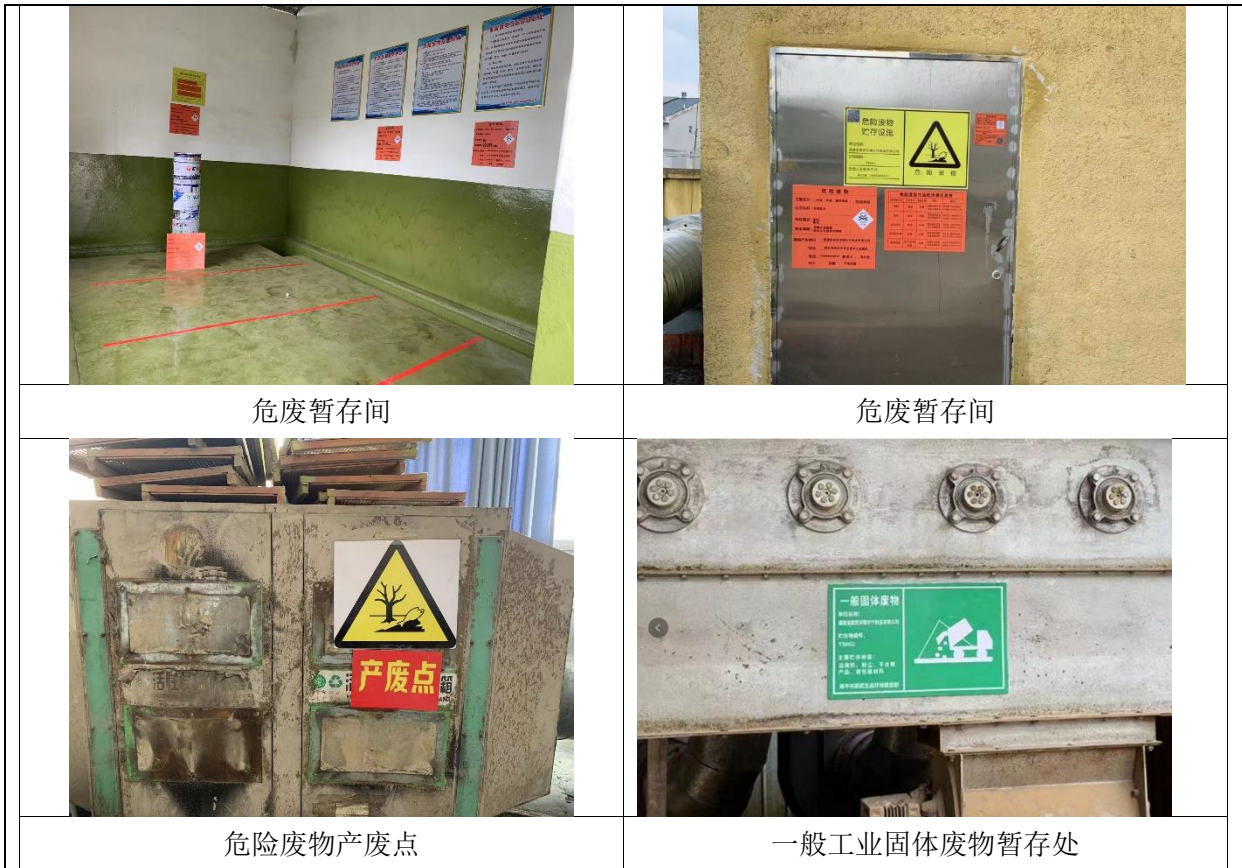
图3-5 危废暂存间设施照片
