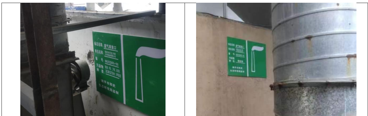
图3-6 废气排放口标识标牌
