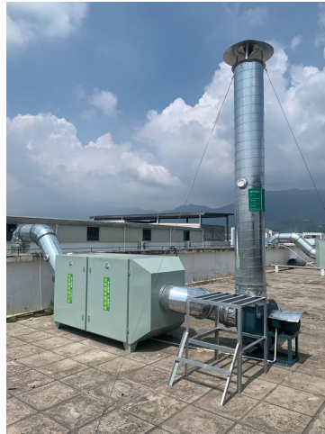
废气处理设施
