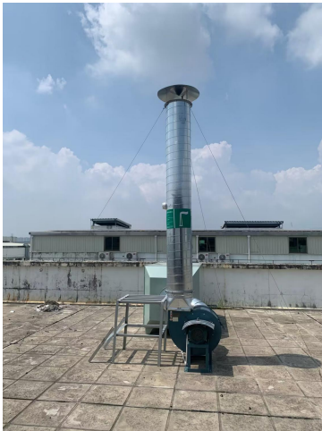
废气排气管道
