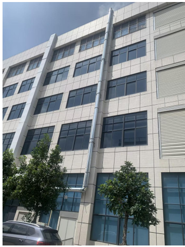
废气收集管道
