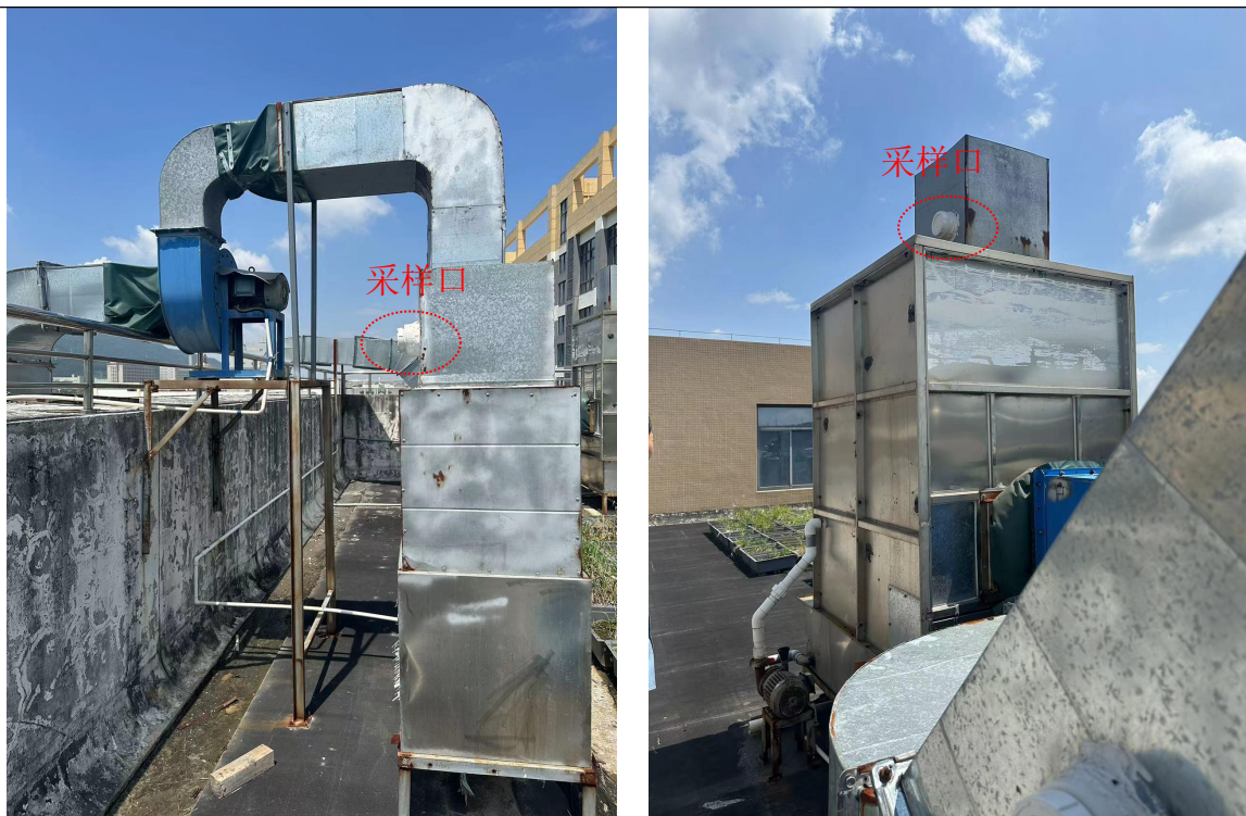
粉尘废气处理设施及排气筒
