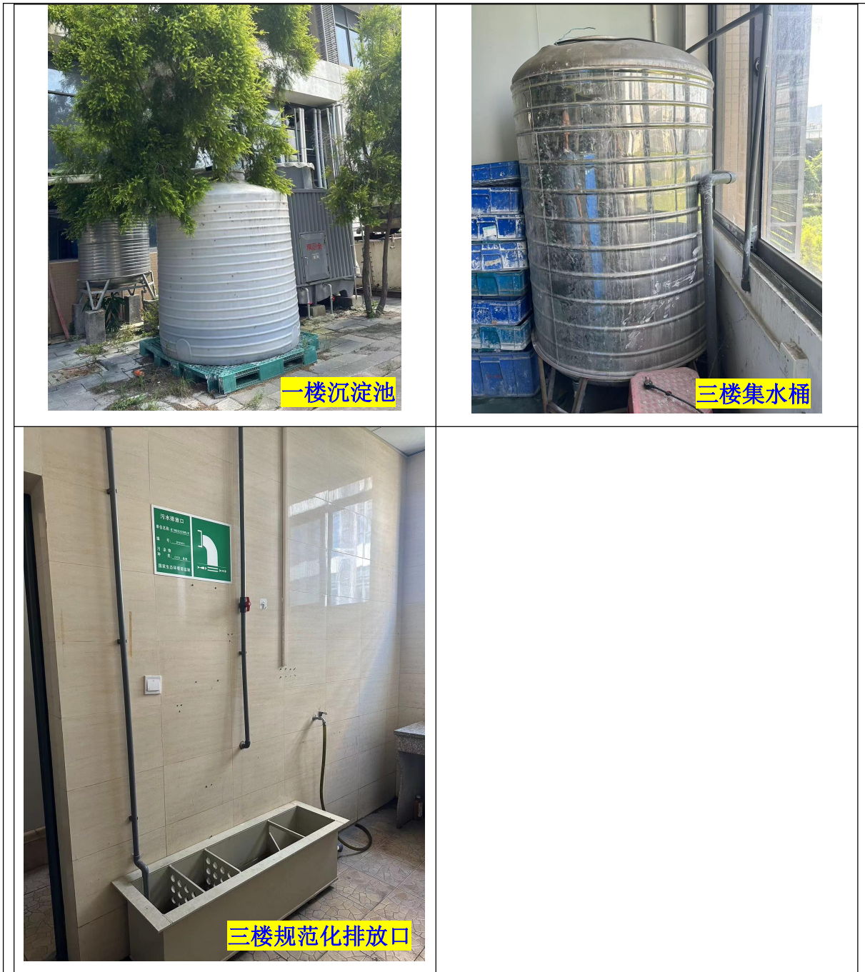
图 3-1 产生废水工序及处理设施相关图片
