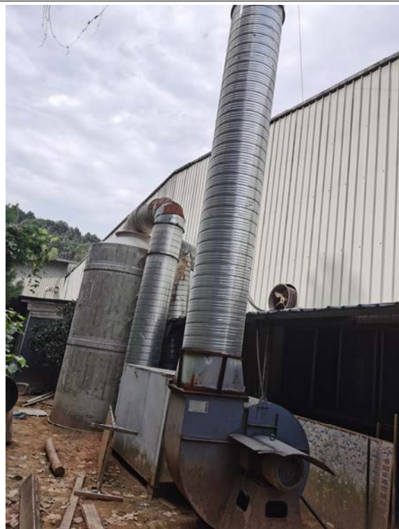
废气处理设施
