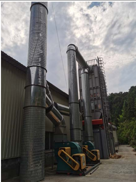
废气处理设施
