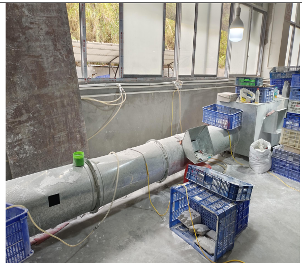
搅浆、打磨修边粉尘废气收集装置
