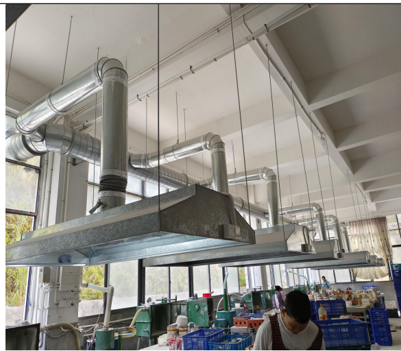
有机废气废气收集装置
