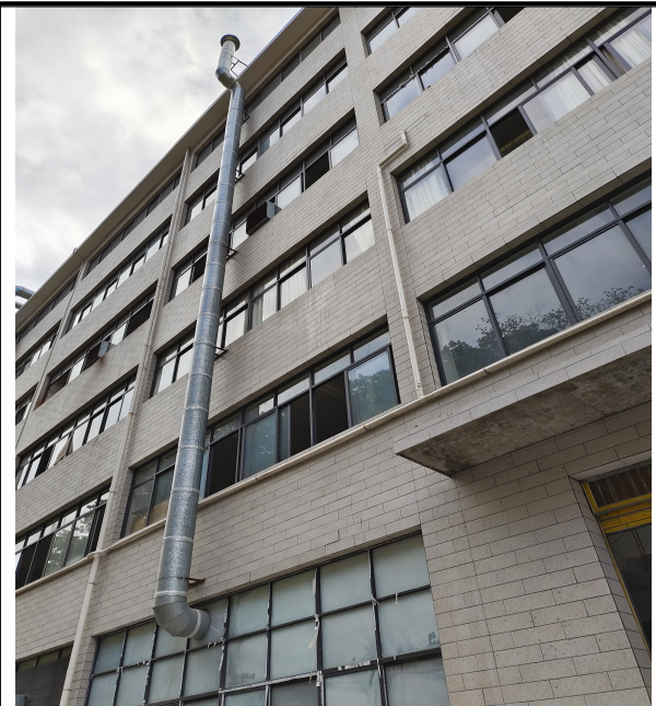
废气管道 (DA002)
