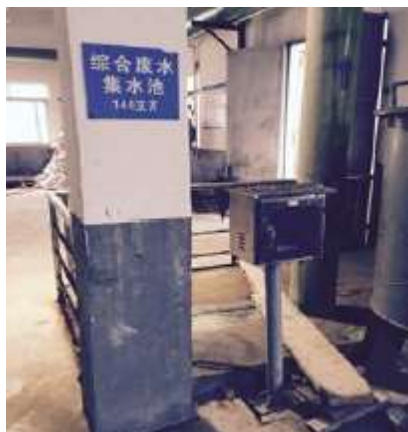
综合废水集水池
