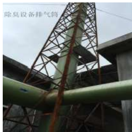
除臭设备排气筒
