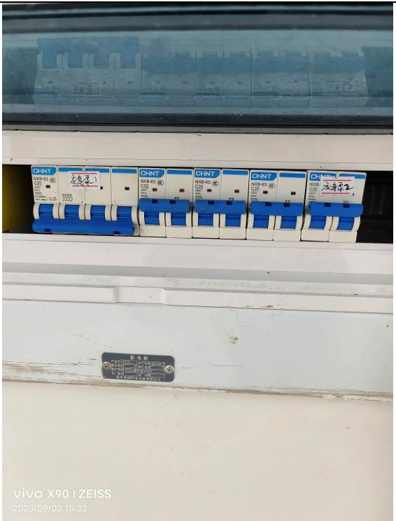
应急切换电源开关
