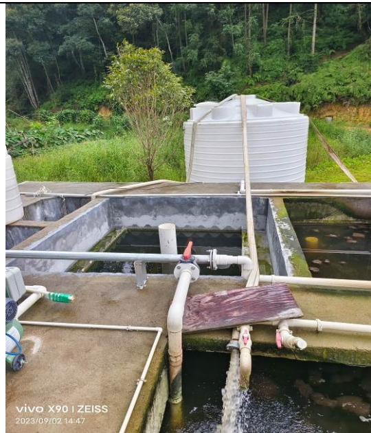
污水处理站、应急桶及应急切换管网
