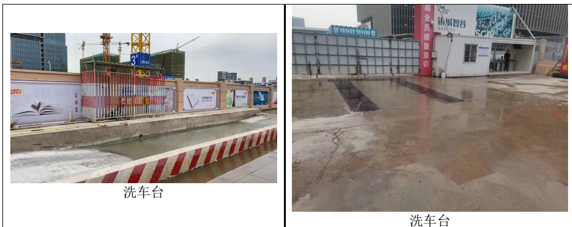
图 4-1 运输车辆设置的清洗设施情况现场图
