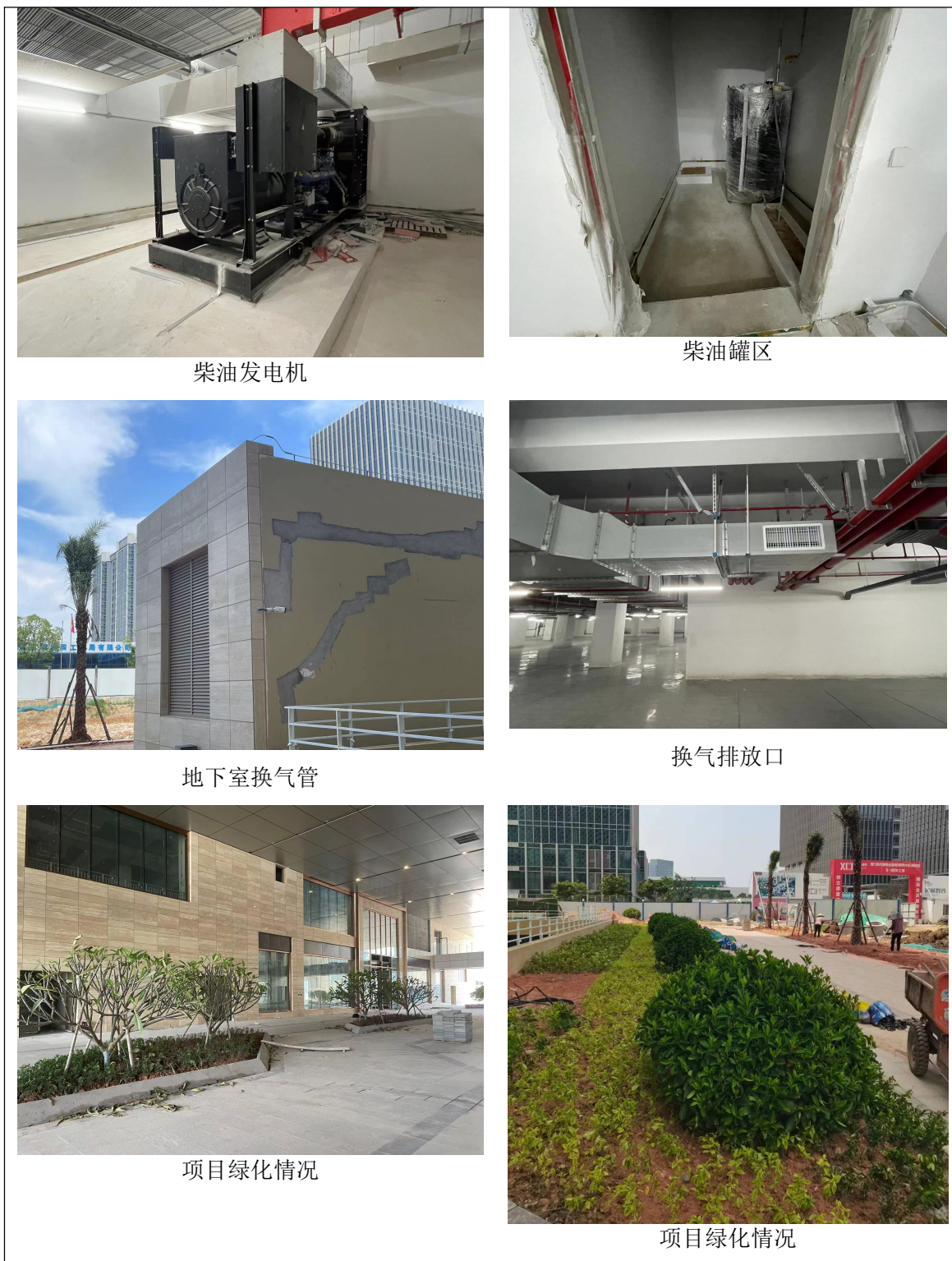
图 4-4 废气设施设置情况现场图
