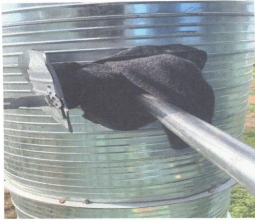
工艺废气出口 1 (Q1 出口)
