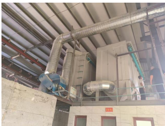
布袋除尘器及排气筒
