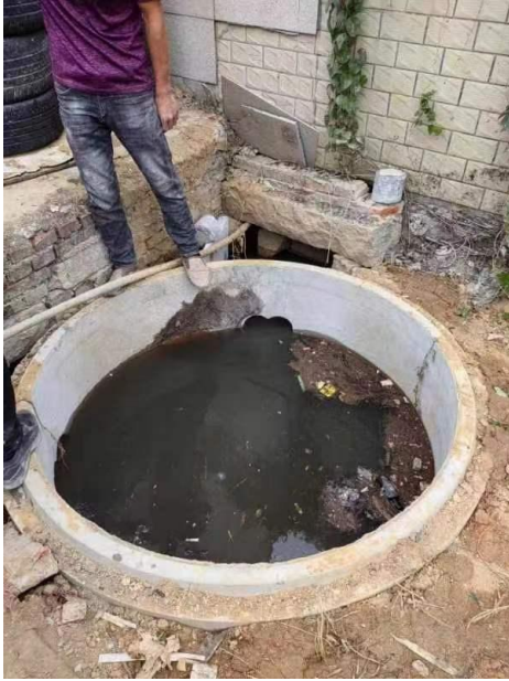
初期雨水沉淀池
