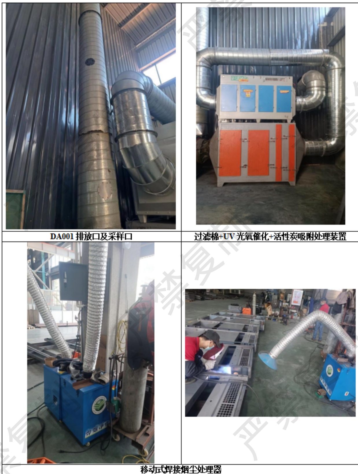
图4.1-2 废气治理设施照片
