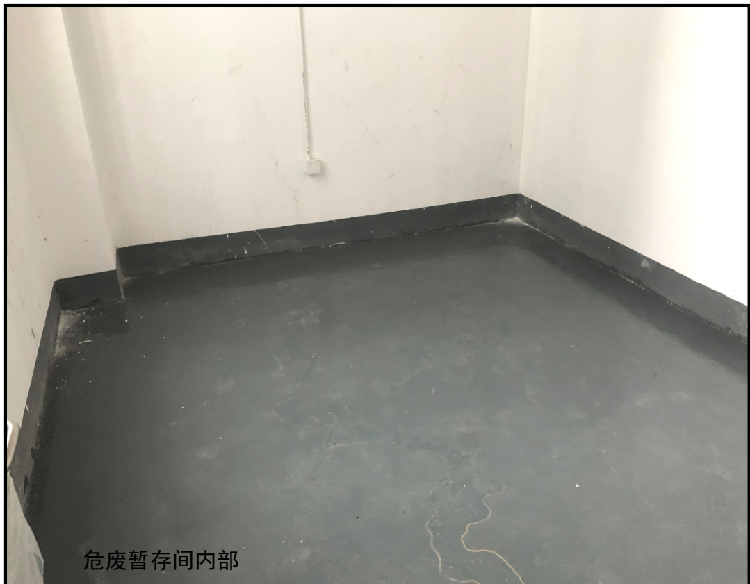
图 4.1-7 项目危废暂存间现场拍摄图
